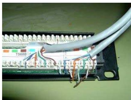
Conexión de los hilos a los conectores del panel de parcheo
