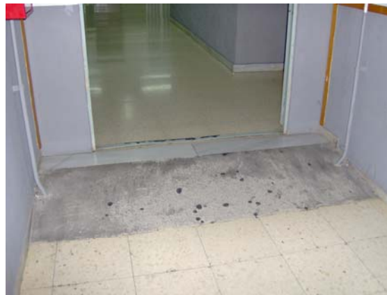
Figura 1. Riesgo de caída al mismo nivel
