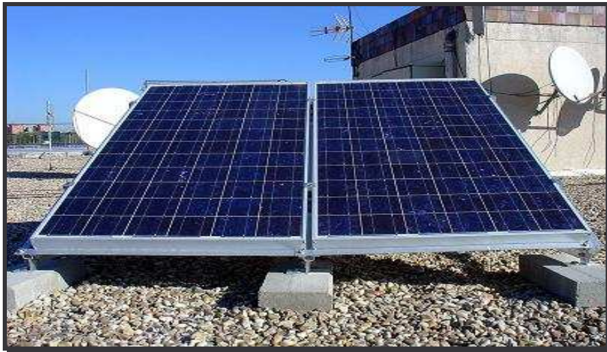
Figura 4. Panel solar fotovoltaico.
